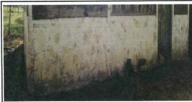
Foto 4: Se ha identificado el deterioro de las columnas del establecimiento, lo que podría comprometer la estabilidad y seguridad de la infraestructura.
