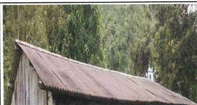
Foto 3: Se ha identificado el deterioro de la cubierta de lámina, presentando daños que permiten la filtración de agua durante la época de lluvias.
