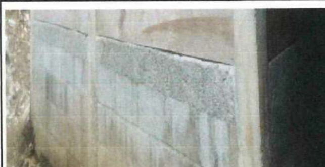
Foto 2: Se ha identificado el deterioro en la pared del establecimiento, evidenciando áreas incompletas que requieren la colocación de block.
